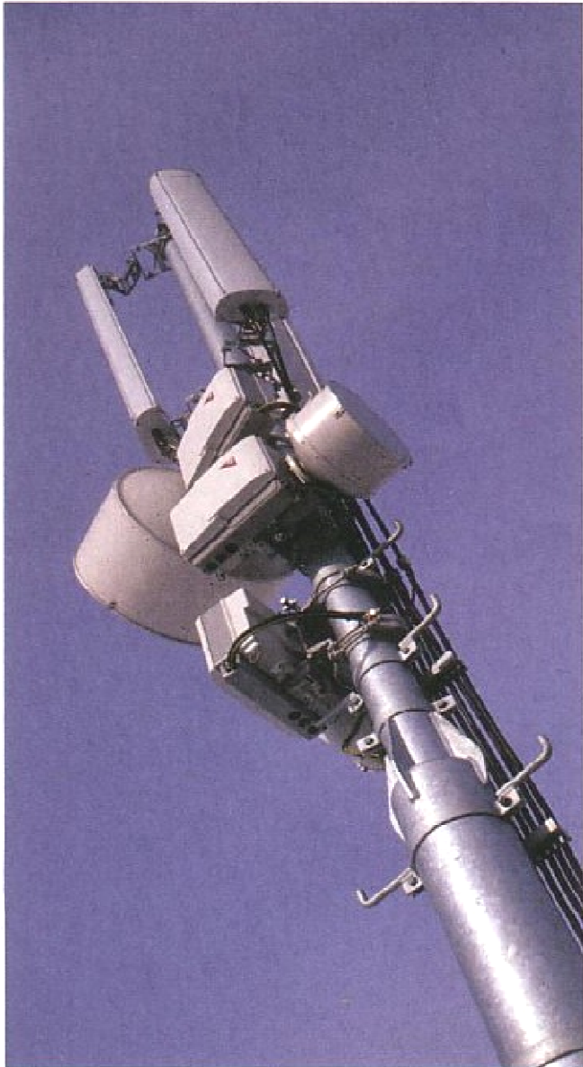
Mast mit Mobilfunkantennen (zuoberst) und Richtfunkantennen (rund). Letztere verbinden die Basisstationen mit den Telefonzentralen.
