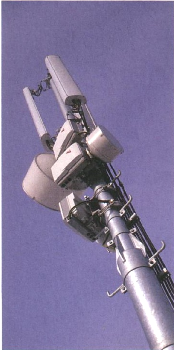
Mast mit Mobilfunkantennen (zuoberst) und Richtfunkantennen (rund). Letztere verbinden die Basisstationen mit den Telefonzentralen.
